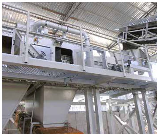
Instalacja BMP w Kosinach Bartosowych
