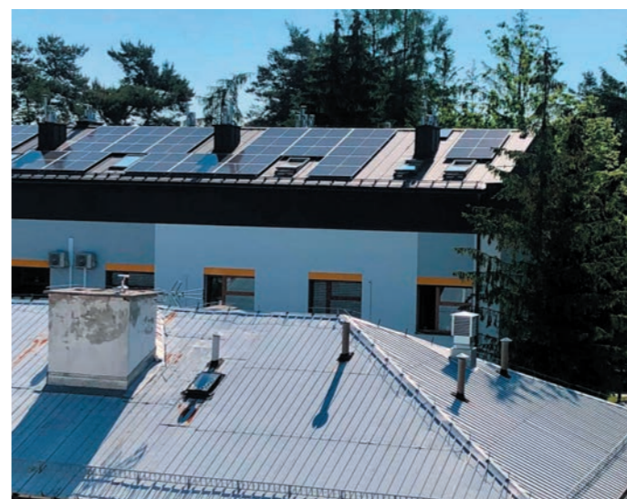
Panele fotowoltaiczne na przychodni
