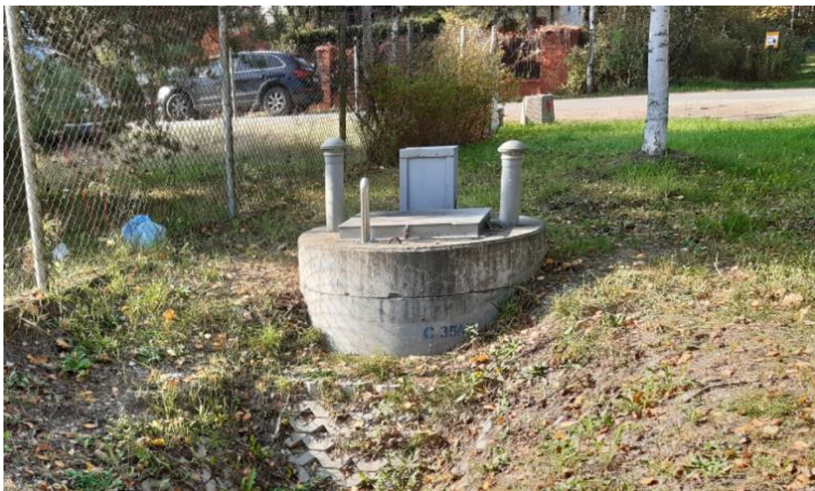
Rycina 107. Pompownia wód deszczowych przy ul. Langiewicza. Fot. własna
