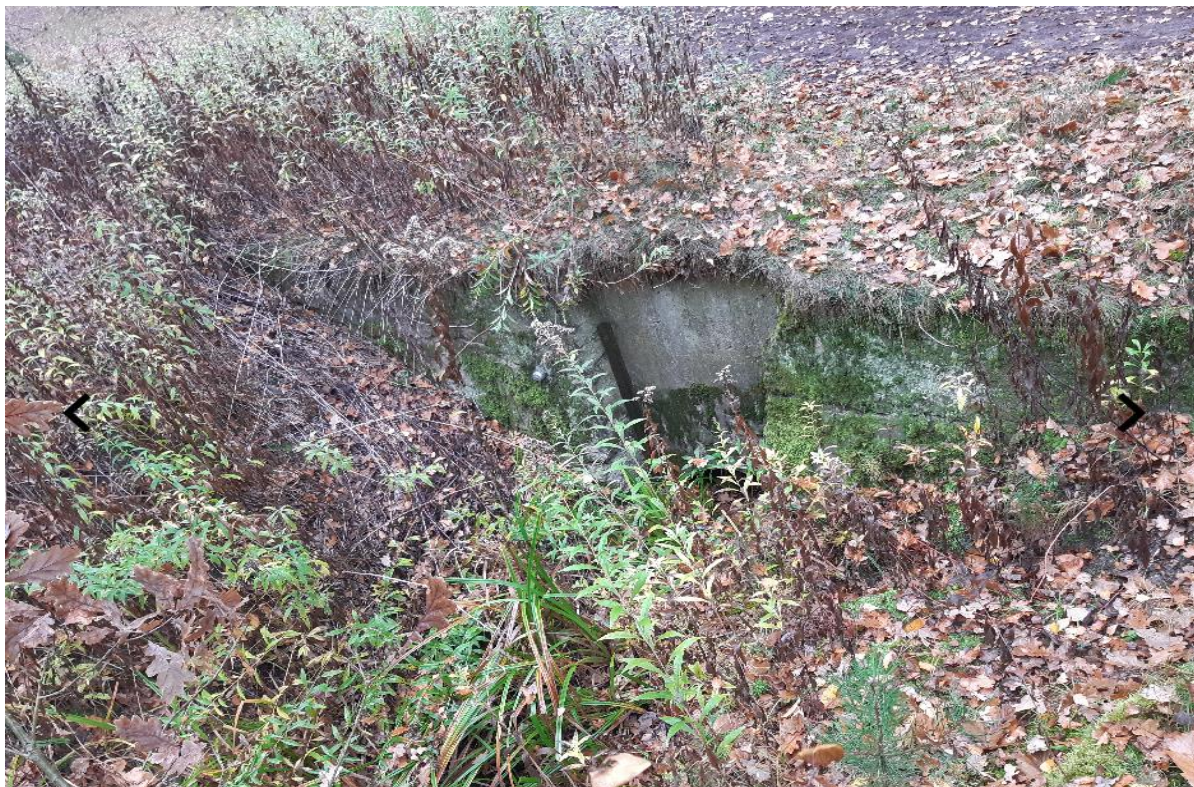
Rycina 112. Niedrożny przepust na Kanale Młocińskim. Fot. własna
