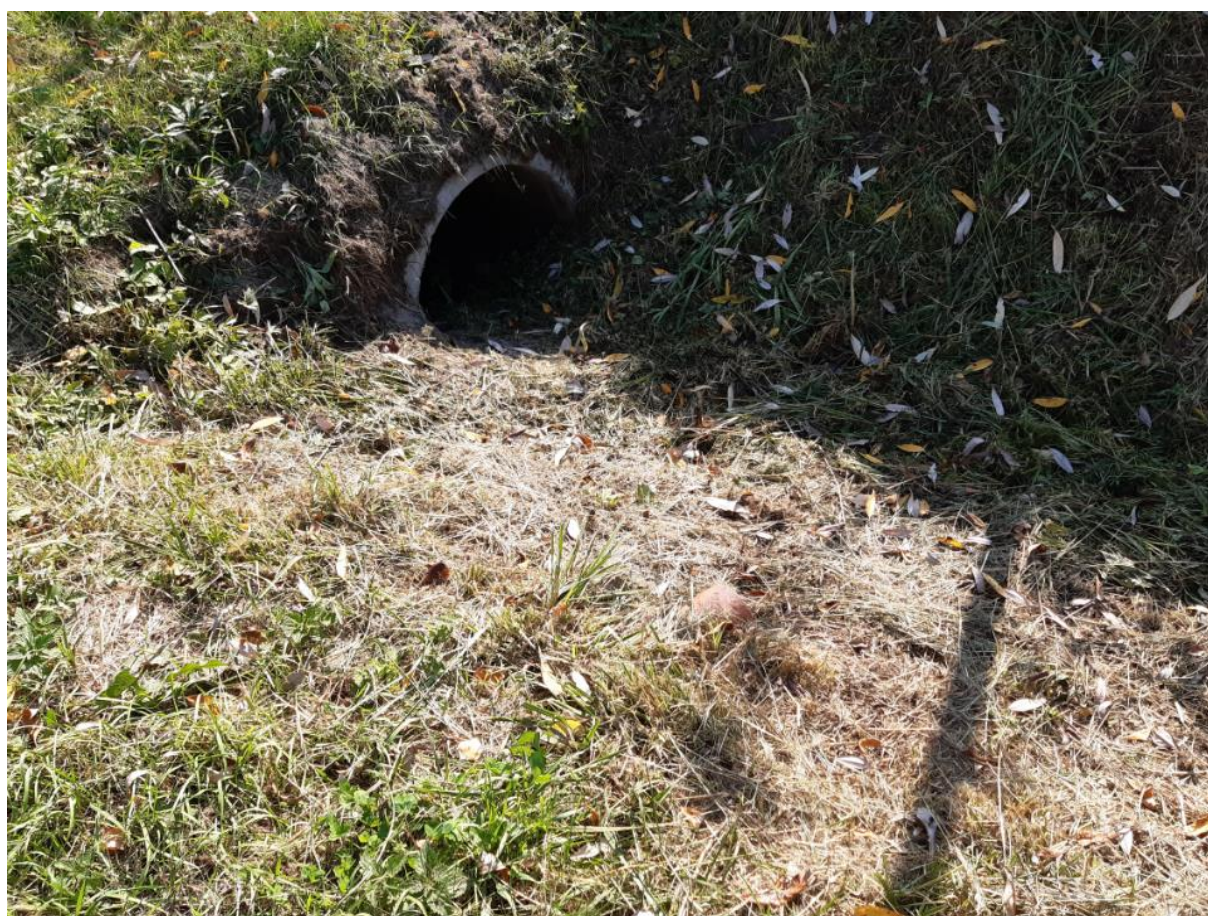
Rycina 115. Częściowo zasypany przepust rogowy na Rowie Północnym (Tuskaw). Fot. własna
